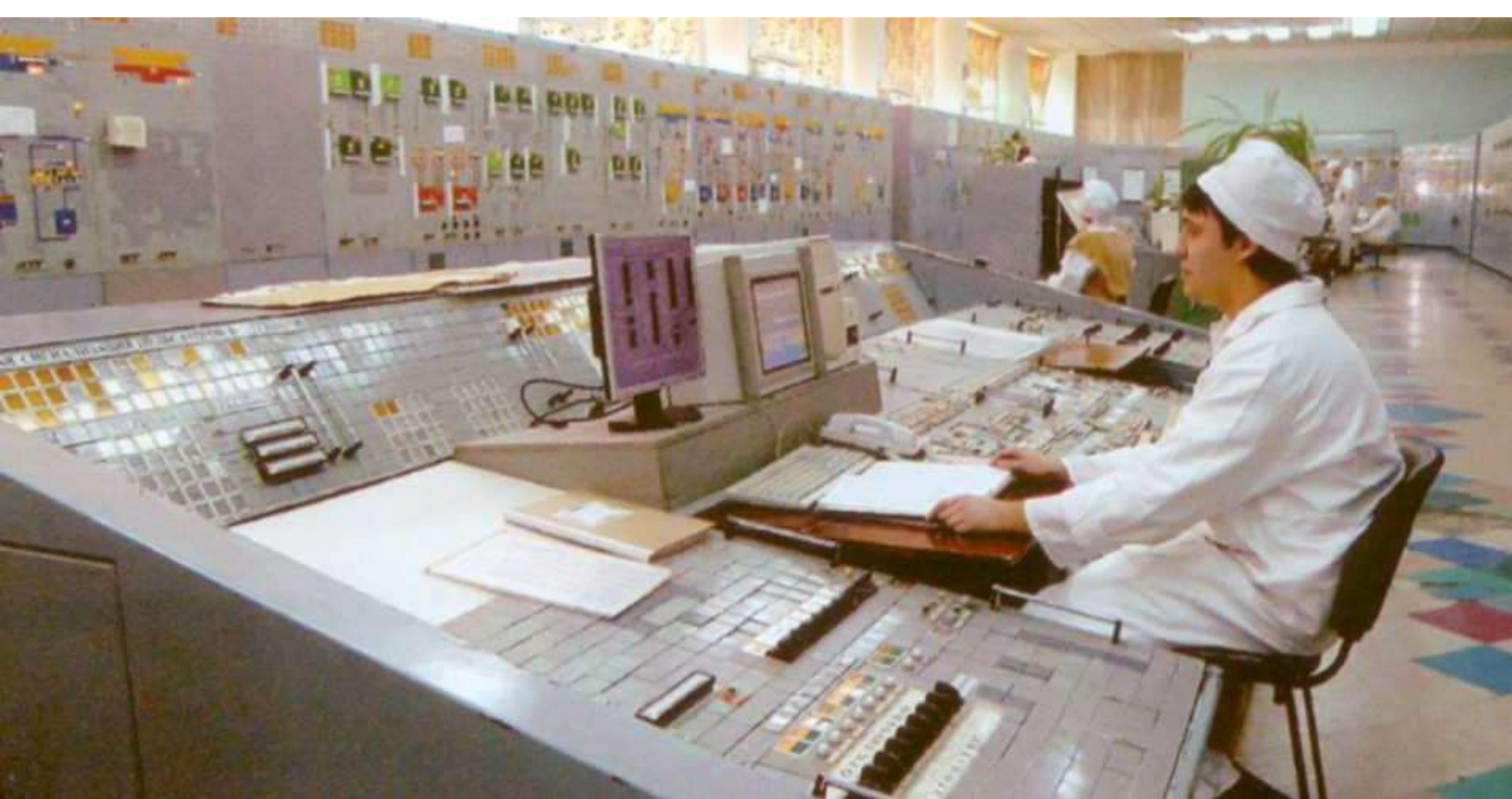
Центральный пульт управления переработкой ОЯТ
