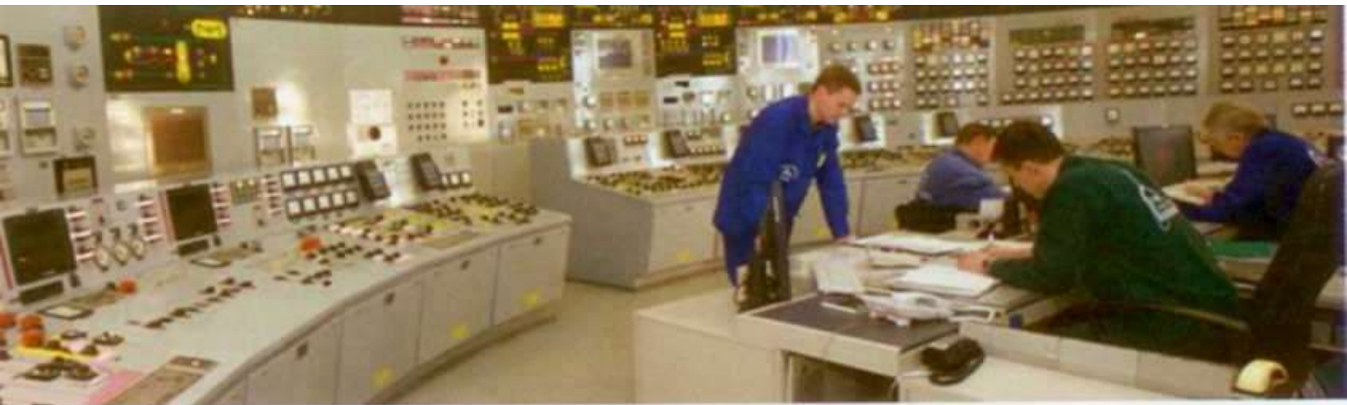
Блочный щит управления АЭС
